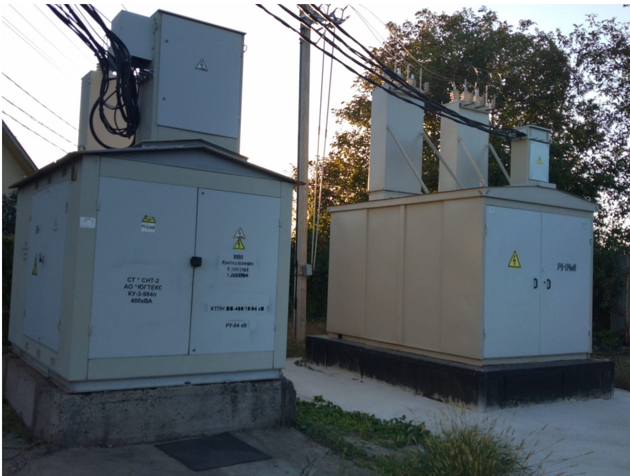
Фото. ПОДСТАНЦИЯ СНТ № 2 АО «ЮГТЕКС»
